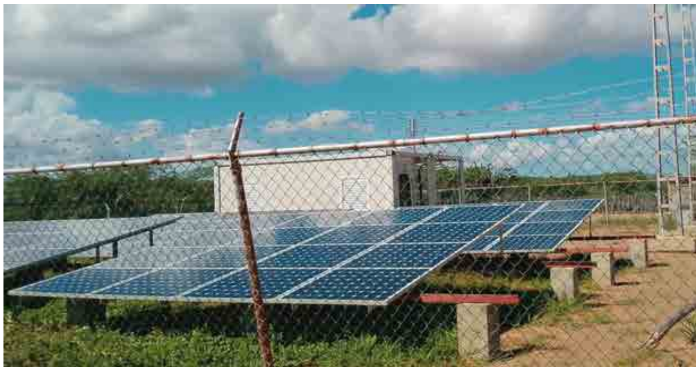
Figura 3. Sistema híbrido de 12 kVA instalado por Fundelec en el Alta Guajira estado Zulia. Guajira Alta Guajira. Ecosistémica
